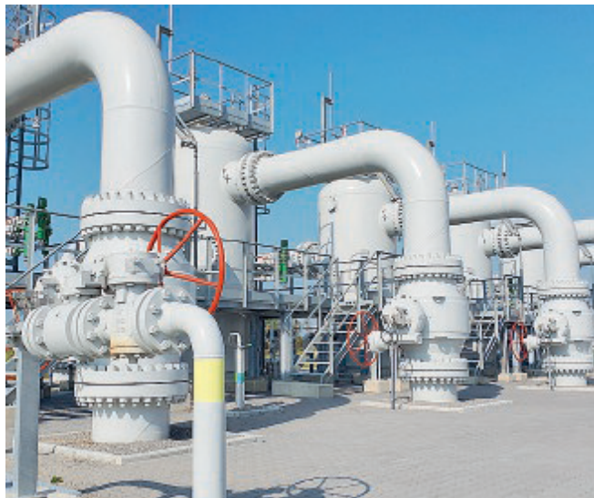
MAX STREICHER La centrale di compressione di Sergnano.
